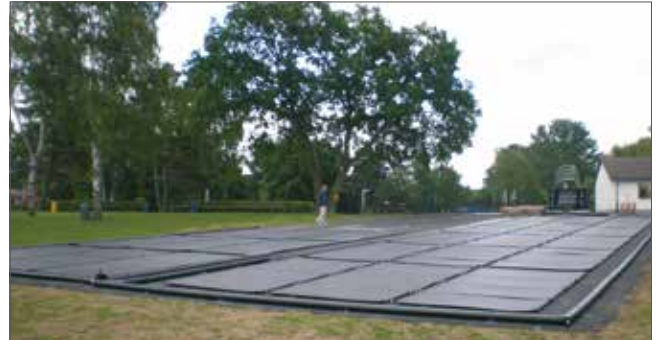
Freiflächenmontage Freibad Wehrheim
